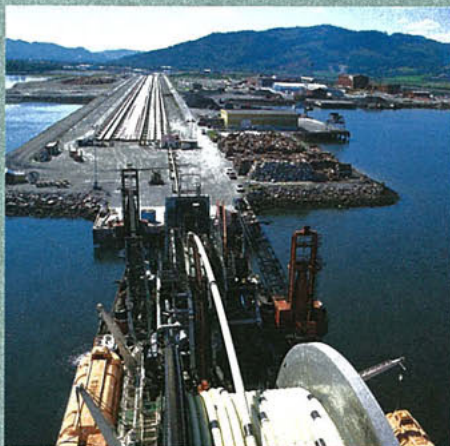
LEGGEFARTØYET APACHE SPOLER OPP RØRENE PÅ EN STOR TROMMEL, OG GÅR DERETTER TIL HAVS FOR Å GJØRE SELVE LEGGEJOBBER PÅ FELTET.
