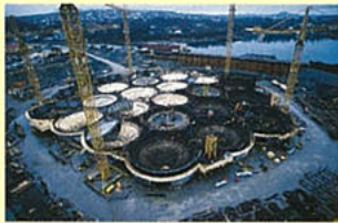
23. august havarerte understellet til Sleipner-A-plattformen. Nytt understell er allerede under bygging.
