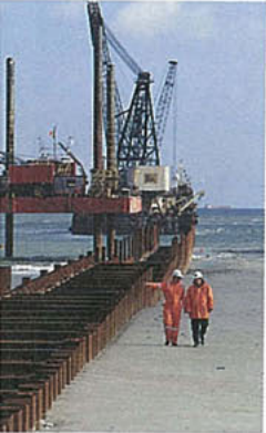
ILANDFØRINGS-PUNKTET FOR NORFRA RØRLEDNINGEN I DUNKERQUE I FRANKRIKE.
