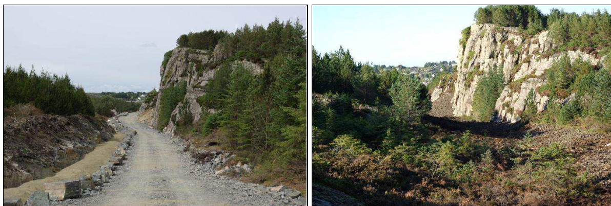
Figur 3.6 Arbeidskorridor under anleggsarbeid til venstre, der rørledning er lagt ned i grøft til venstre for anleggsveien og omfylt med sand. Avsluttet tilbakeføring av landskapet til høyre.
