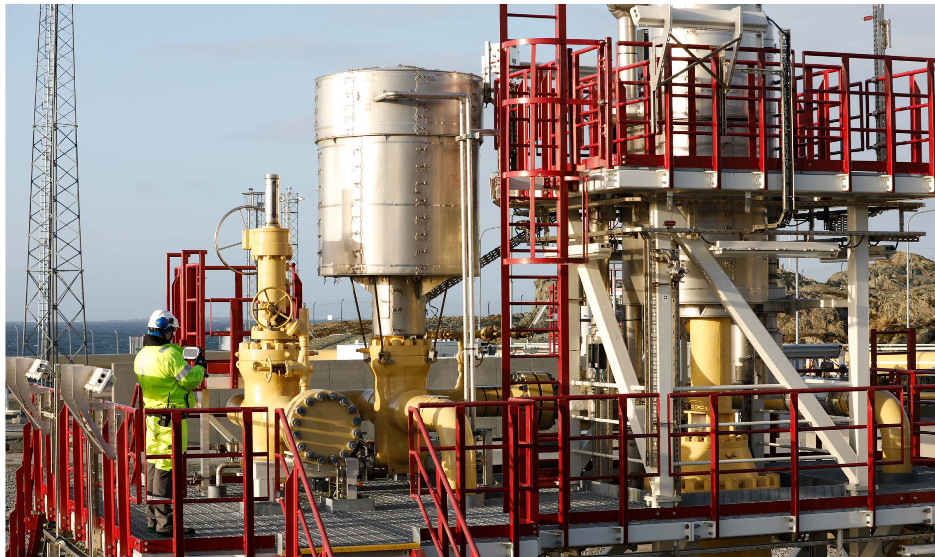
llandføringsanlegget på Kalstø, Rogaland.
