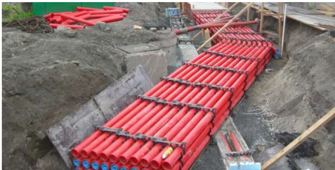
Figur 2-3 Eksempel på en OPI-kanal (Equinor vil kun ha et eller to rør, men prinsippet er det samme). Med unntak av kortere strekninger på 20-30 meter for hver 800 meter pga. «kabelstrekker», vil grøften reetableres fortløpende og maks innen en uke. Kabelen trekkes helt til slutt.
