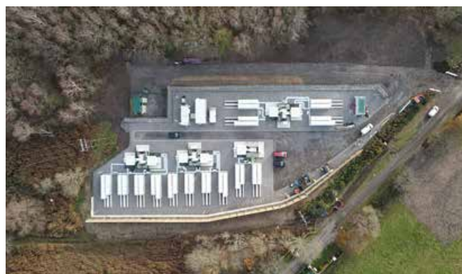
Blandford Road batterilagringsanlegg, Dorset, Storbritannia.
