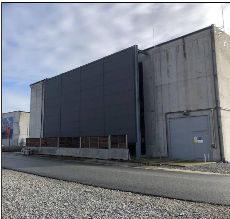
Figur 6-1. Eksempel på tiltak mot støy: vegg og støyskjerm er satt opp for å redusere støy fra transformatorene for Johan Sverdrup på Haugsneset.
