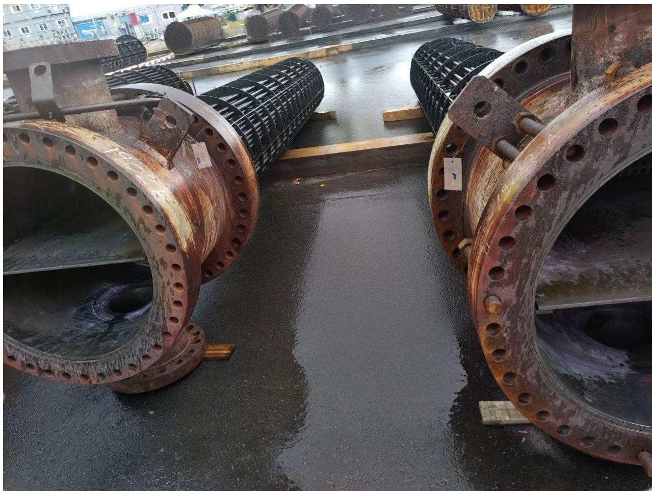
Figur 6-2 Bilde av varmeveksler E-1902 A og B lagret på inspeksjonsplass
