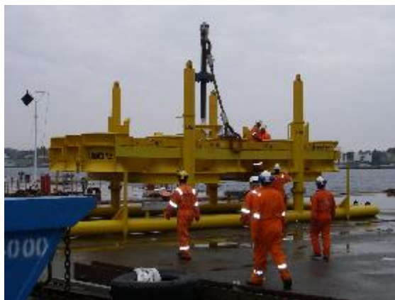
Figur 2-4. Brønnramme før installering offshore.
